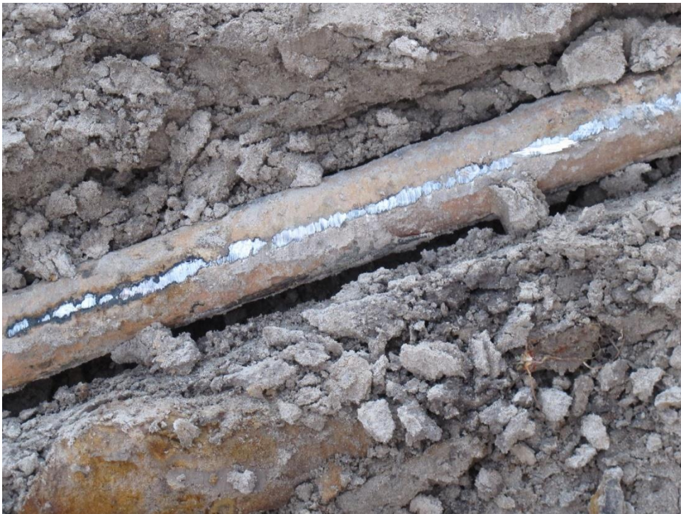
Figuur A.7 Beschadiging tgv graafwerkzaamheden.
