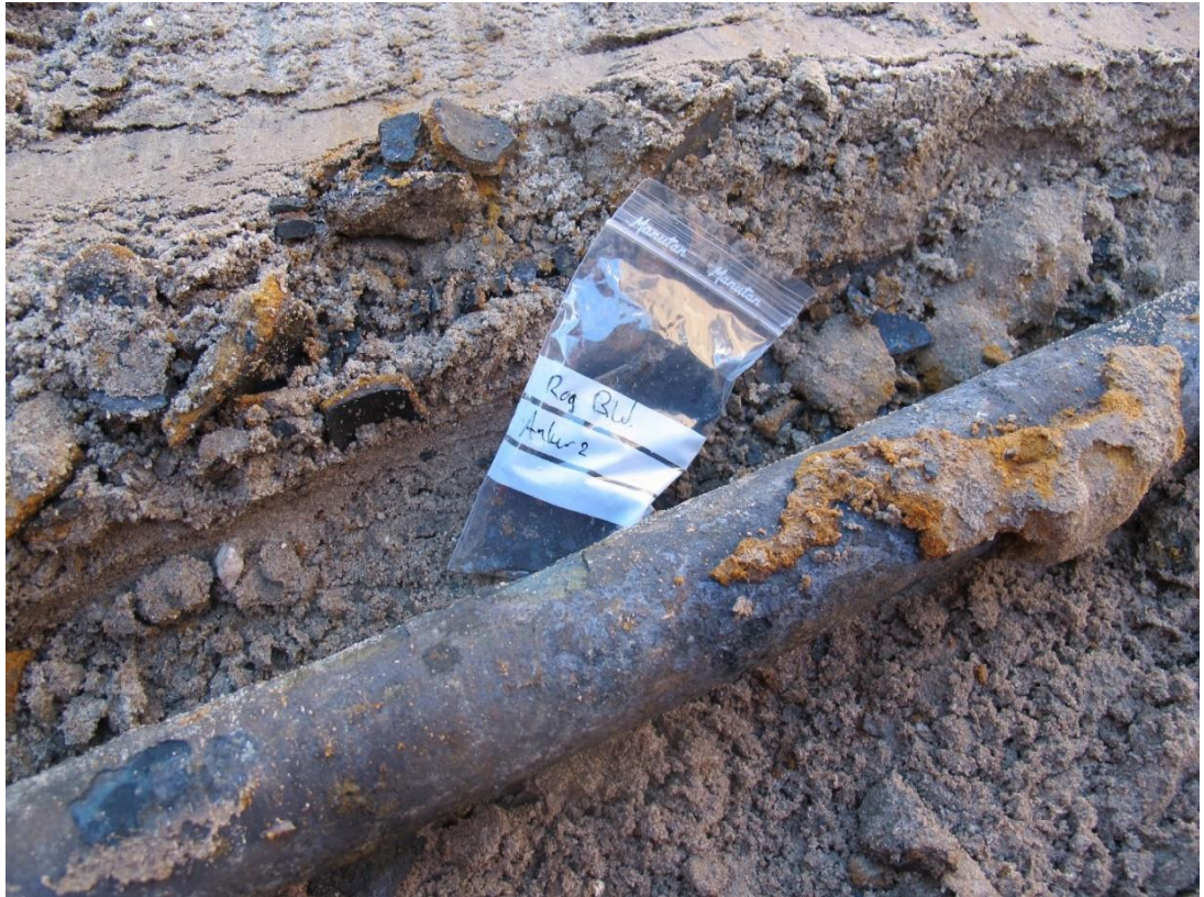
Figuur A.8 Detail van een anker en afgebrokkelde stukken van de laag om het anker en met sample zakje.
