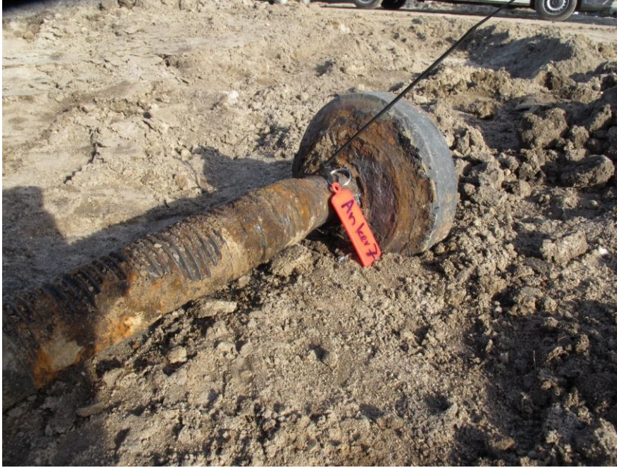
Figuur 6.2 Uiteinde waterzijde ankerstang 7 met schroefdraad en schotel Binnenhoofd-west.
